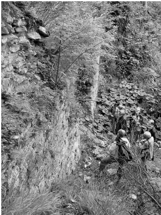
Fot. 4. Zewnętrzne lico muru tarczowego przy cysternie, stan w lipcu 2004 r. Widoczny głęboki ubytek, zagrażający stabilności muru. (Fot. P. Stepień)
